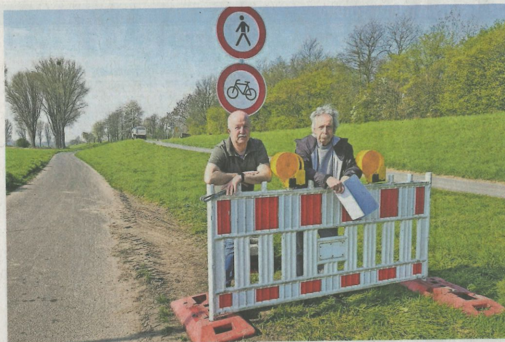
Erik Heinen und Franz Josef Bauers vom Deichverband an der Baustelle, die augenscheinlich umfahren worden ist.
